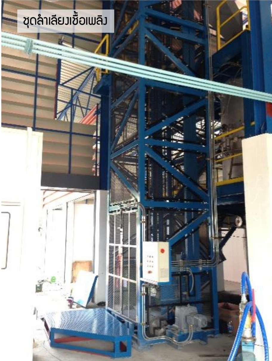
ตู้ควบคุมการทำงานชุดลำเลียง
