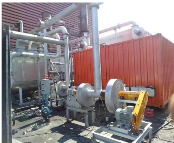
พัดลมดูดอากาศสำหรับใช้ลำเลียงความร้อนเข้าตู้อบ/ บำบัดมูลฝอยติดเชื้อ
