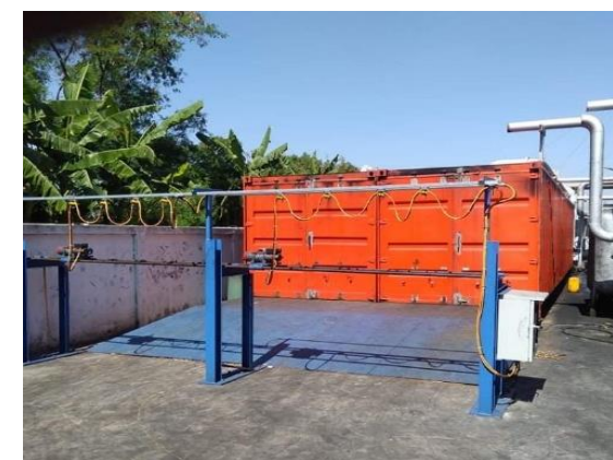
ตู้อบ/บำบัดขยะติดเชื้อ และระบบลำเลียงรถเข็นบรรทุก มูลฝอยติดเชื้อออกจากตู้อบ
